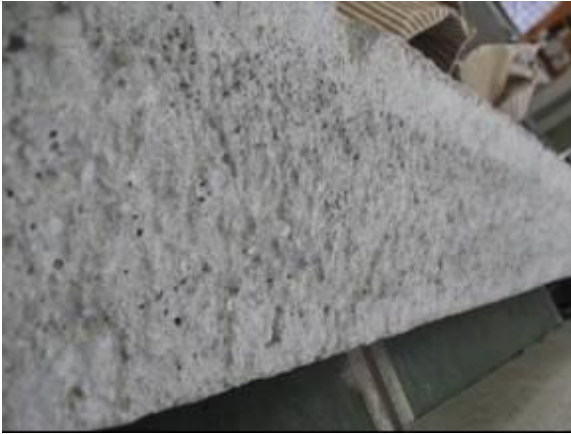
Figura 7: Terminación de la cara inferior de la viga
