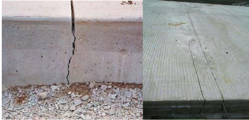
Figura 1. El corte ocasiona la aparición de la fisura en la junta (Taylor P.; et al, 2007)
