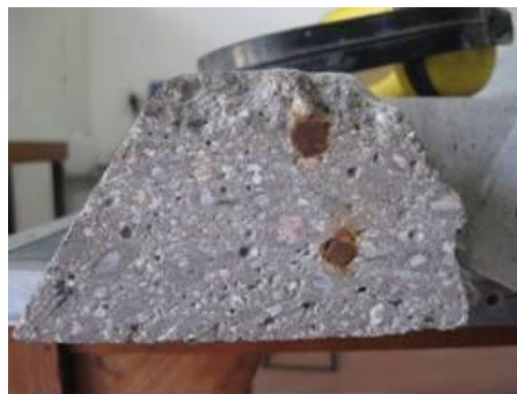
Figura 6: Presencia de armadura en el slat
