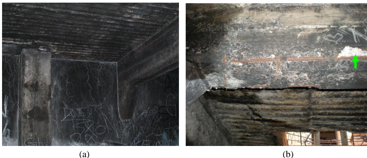
Figura 4. (a) Efectos del incendio en el subsuelo y (b) detalle del estallido del hormigón en viga, indicando con la flecha el lugar de toma de muestra del material para análisis.
