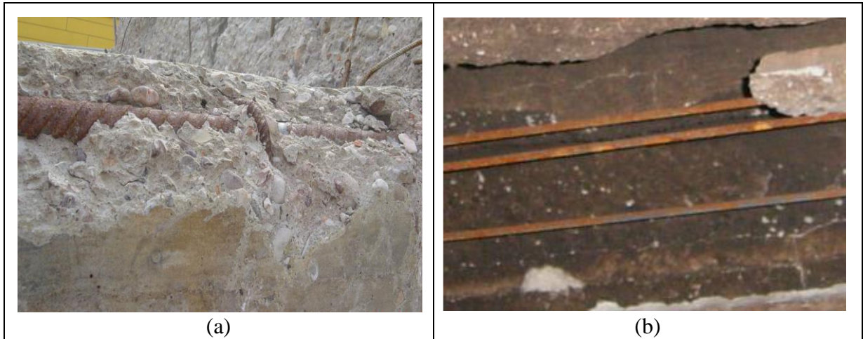
Figura 2. a) Armadura expuesta en esquina en viga. b) Explosión en vigueta pretensada y acero expuesto tras saltado del recubrimiento.
