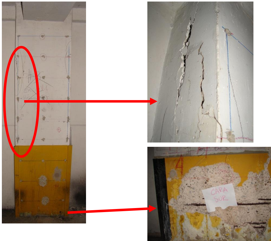
Figura. 4. Vista de una de las columnas del sótano donde se muestran grietas con delaminación del concreto y acero expuesto con productos de corrosión negros.
