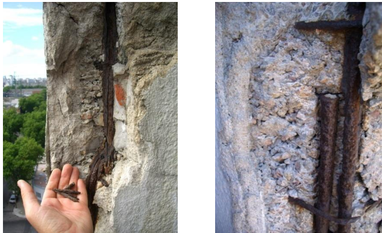
Figura 14. Pilares decorativos com corrosão acentuada em área com concreto de alta porosidade.
