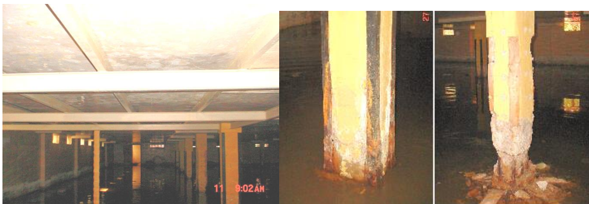
Figura 5.- Izquierda: Vista General de las Columnas en el Sótano. Nótese los perfiles de acero en las zonas inferiores de las mismas y la inundación con agua. Derecha: Vista cercana de una columna típica con perfiles de acero en las esquinas y luego de retirarse los mismos, nótese el desprendimiento del concreto fofo y la armadura con corrosión severa.
