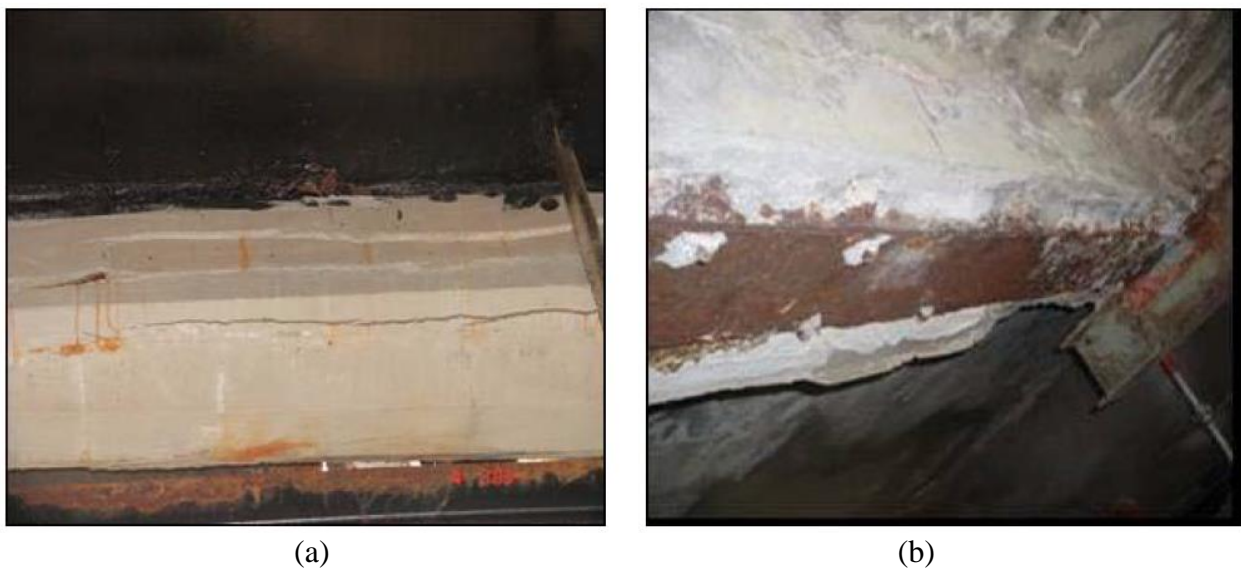
Figura 7. Levantamiento fotográfico de algunas vigas secundarias con los daños típicos encontrados. a) agrietamiento, b) delaminación con acero expuesto y concreto restante lixiviado y con depósitos de sal.
