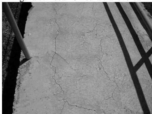
Figura 9. Fisuras en losa
