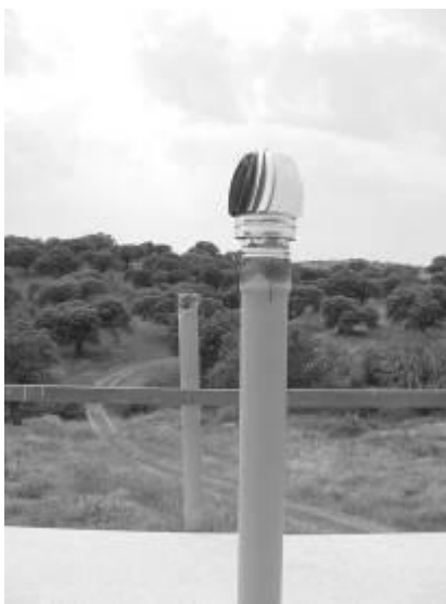
Figura 15. En esta fotografía se encuentra abierto el tiro de la arqueta situada bajo el módulo mientras que el otro tubo está sellado.
