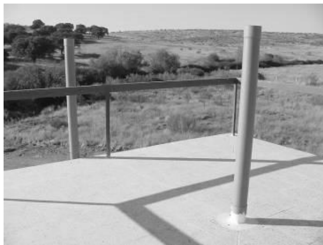
Figura 14. Salida de los tubos a cubierta. En esta fotografía se encuentran sellados en su extremo.
