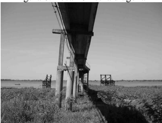
Figura 8. Pilares con desaplomo
