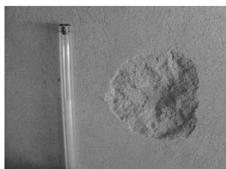
Figura 6. Ruptura tipo profunda
