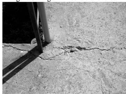
Figura 7. Losa 18 fisura transversal
