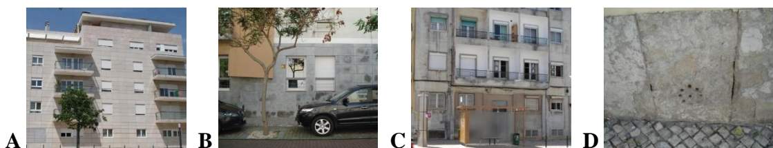
Figura 1. Condições de degradação dos revestimentos pétreos
