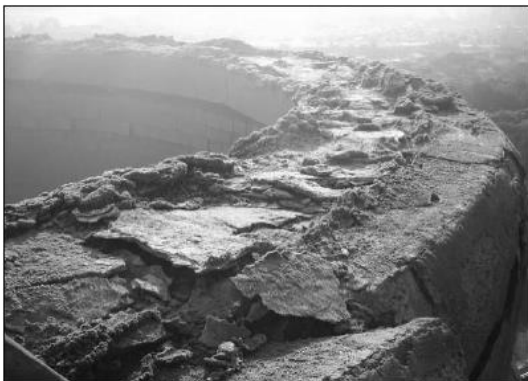
Figura 8. Esfacelamento do topo por causa do choque térmico
