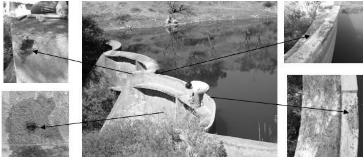
Figura 8. Prueba de carbonatación en diferentes puntos de la micropresa D
