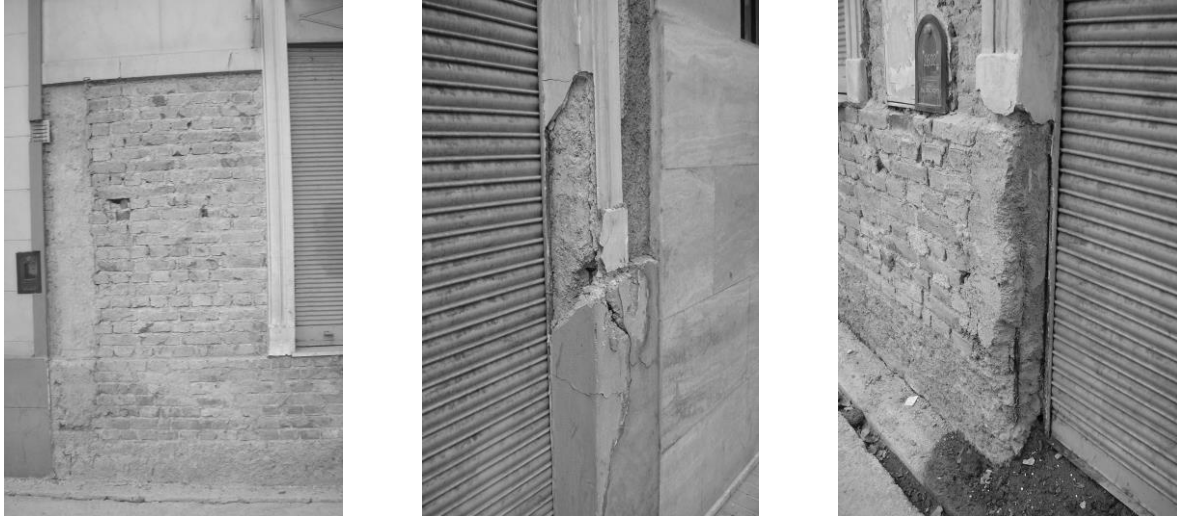
Figura 2. Falta de columna de borde – Estado de conservación de columnas de borde
