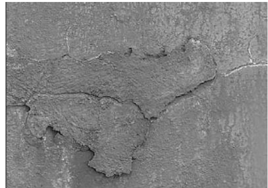
Figura 9. Destacamentos do concreto por causa da corrosão das armaduras
