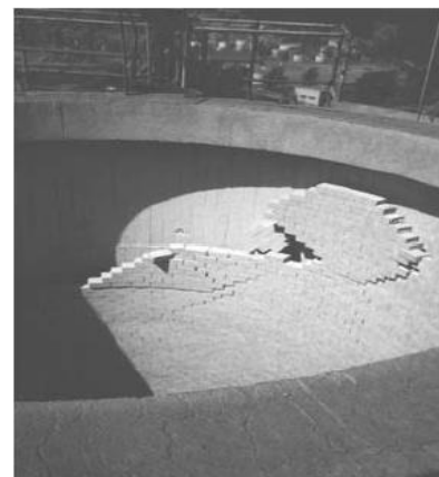
Figura 6. Queda de tijolos refratários no topo, conforme indicado no termograma da figura 5
