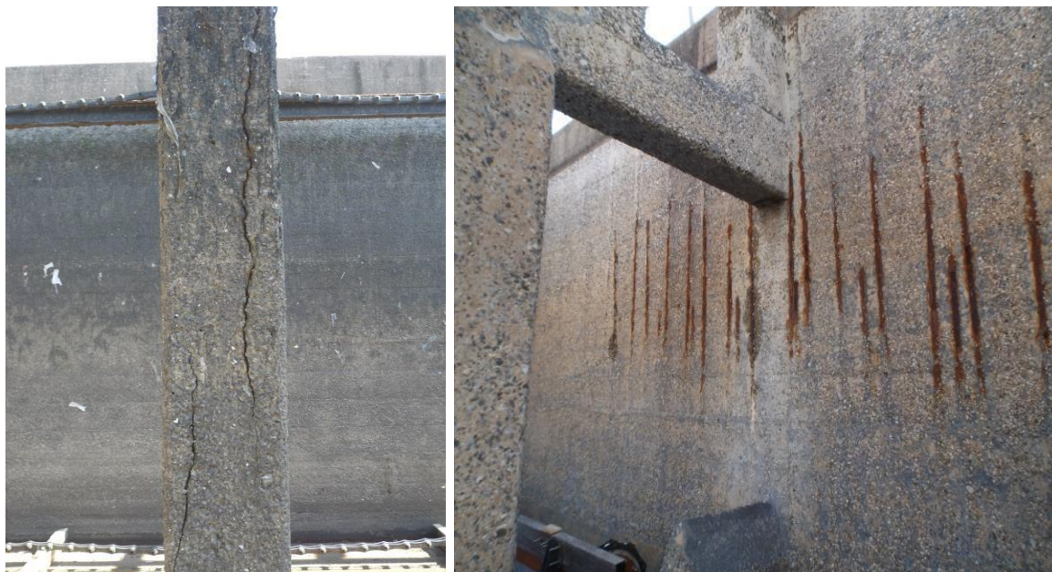
Figura 1. Colunas de concreto fissuradas, com deslocamentos e reparos. Armaduras expostas e corroídas.
