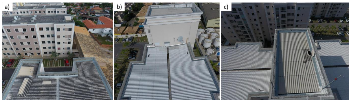
Figura 3. Ejemplos de daños en el techo abordados en esta investigación: a) Presencia de teja extra en la dirección transversal del techo; b) Integridad del canal (oxidación); c) Abrir trampilla.
