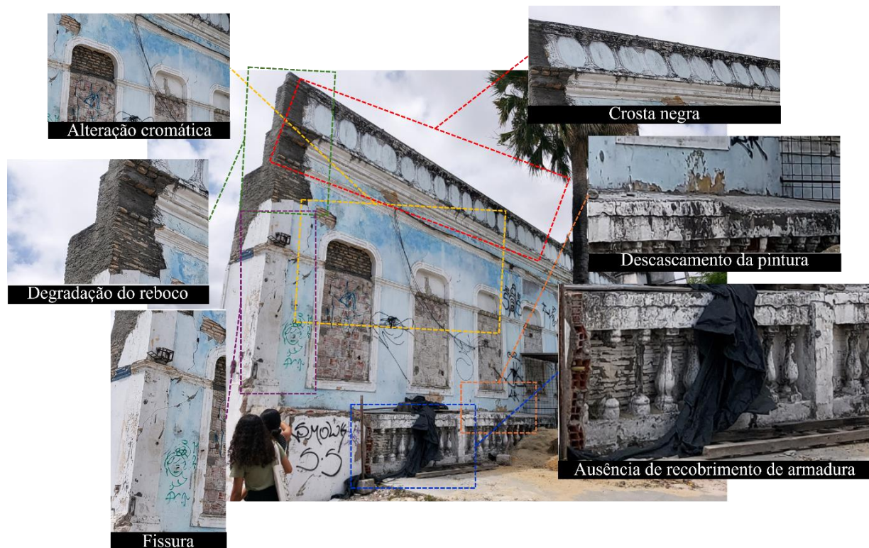
Figura 4. Manifestaciones patológicas identificadas en las fachadas del Casarão
