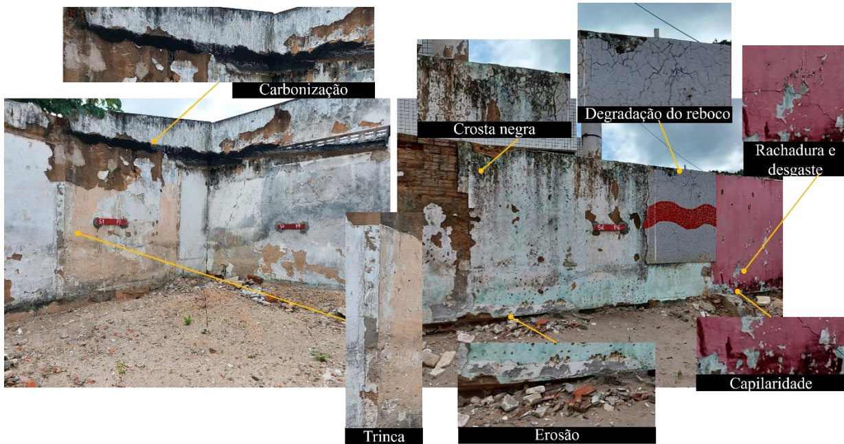
Figura 2. Manifestações patológicas observadas nas paredes internas do Casarão
