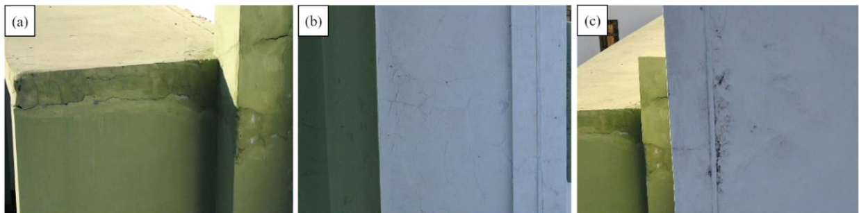
Figura 10. Manifestaciones patológicas de la fachada oeste tras 6 meses de revitalización: Fisuras, desprendimientos y eflorescencias (a), Abombamiento y fisuras mapeadas (b), Suciedad y descamación.
