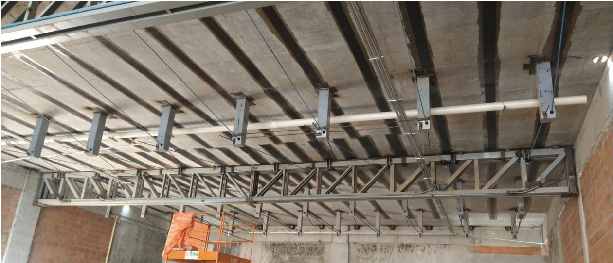
Figura 9. Postensado externo en la losa de cubierta del auditorio.
