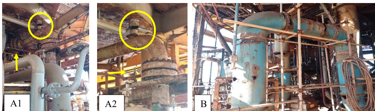
Figura 4. Danos em linhas e acessórios.
