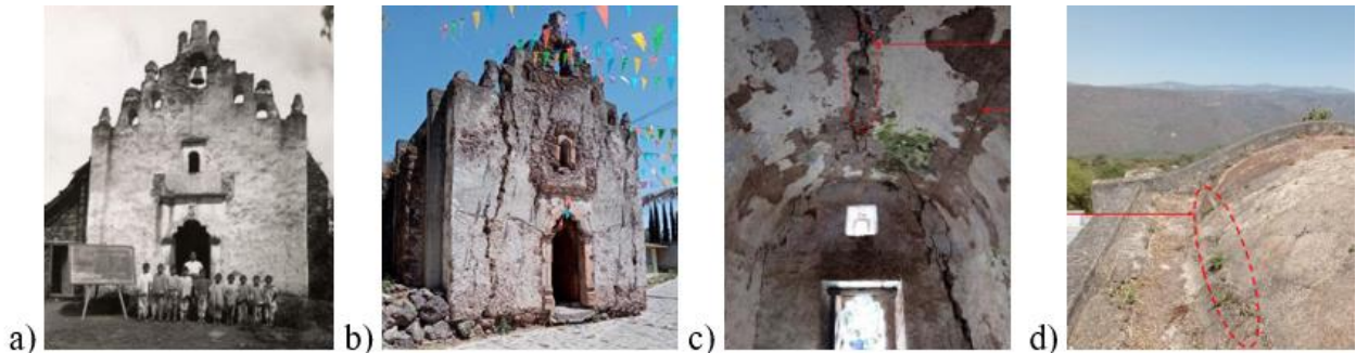
Figura 2. Templo de la Santa Catarina; a) edificio conservado (Biblioteca Tomás Navarro Tomás, 2023); b) estado actual del templo; c) y d) grietas en la clave y los riñones, respectivamente. Tomado de (Segovia, M. A., 2022).
