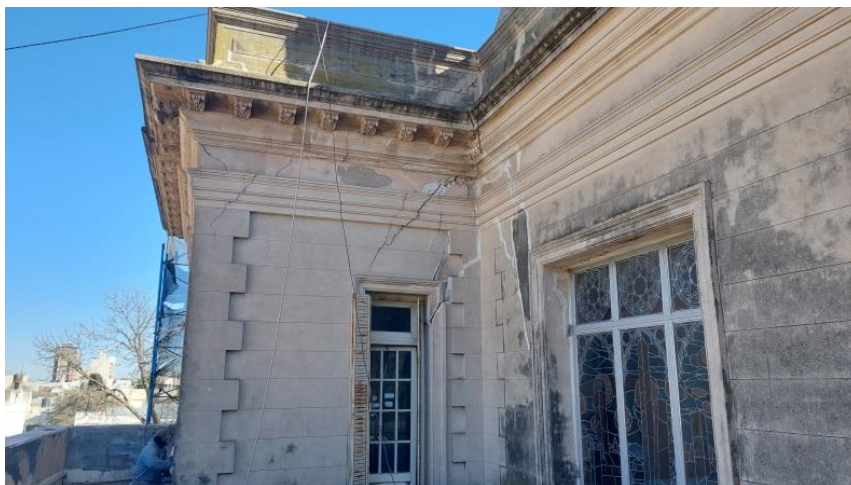
Figura 6. Os assentamentos diferenciais originaram esforços diagonais de tração nos muros, resultando no surgimento de fissuras parabólicas perpendiculares à diagonal tracionada.
