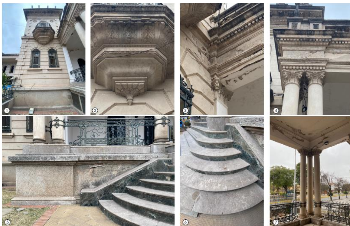
Figura 5. Levantamento fotográfico dos degradês. 5.1) e 5.2): fissuras no revestimento inferior do balcão, devido à corrosão da estrutura de armadura interna. 5.3), 5.4) e 5.7): o deslocamento da estrutura metálica da entrada, devido a assentamentos diferenciais, causou fissuras de tração e estiramento nas junções com paredes estruturais, resultando na entrada de infiltrações de água e na consequente degradação do revestimento semelhante a pedra. 5.5) e 5.6): afundamentos diferenciais das colunas do terraço sobre a entrada, com inclinações nas linhas de molduras e ruptura de placas de revestimento, inclusive na escadaria.
