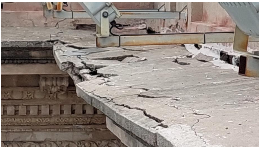
Figura 9. Deformação e ruptura da estrutura metálica da armação da cornija.
