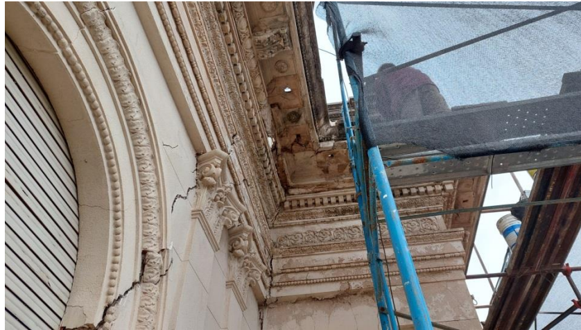
Figura 7. Detalhe de fissuras com deslocamento entre fragmentos de muros.
