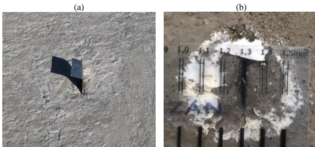
Figura 11. Fissuras: (a) Fissura ainda com a lâmina, (b) Fissura após a retirada da lâmina
