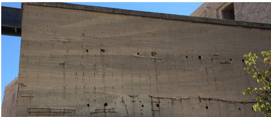
Figura 3. Corrosão induzida por carbonatação em zonas de ausência ou cobertura inadequado de concreto.
