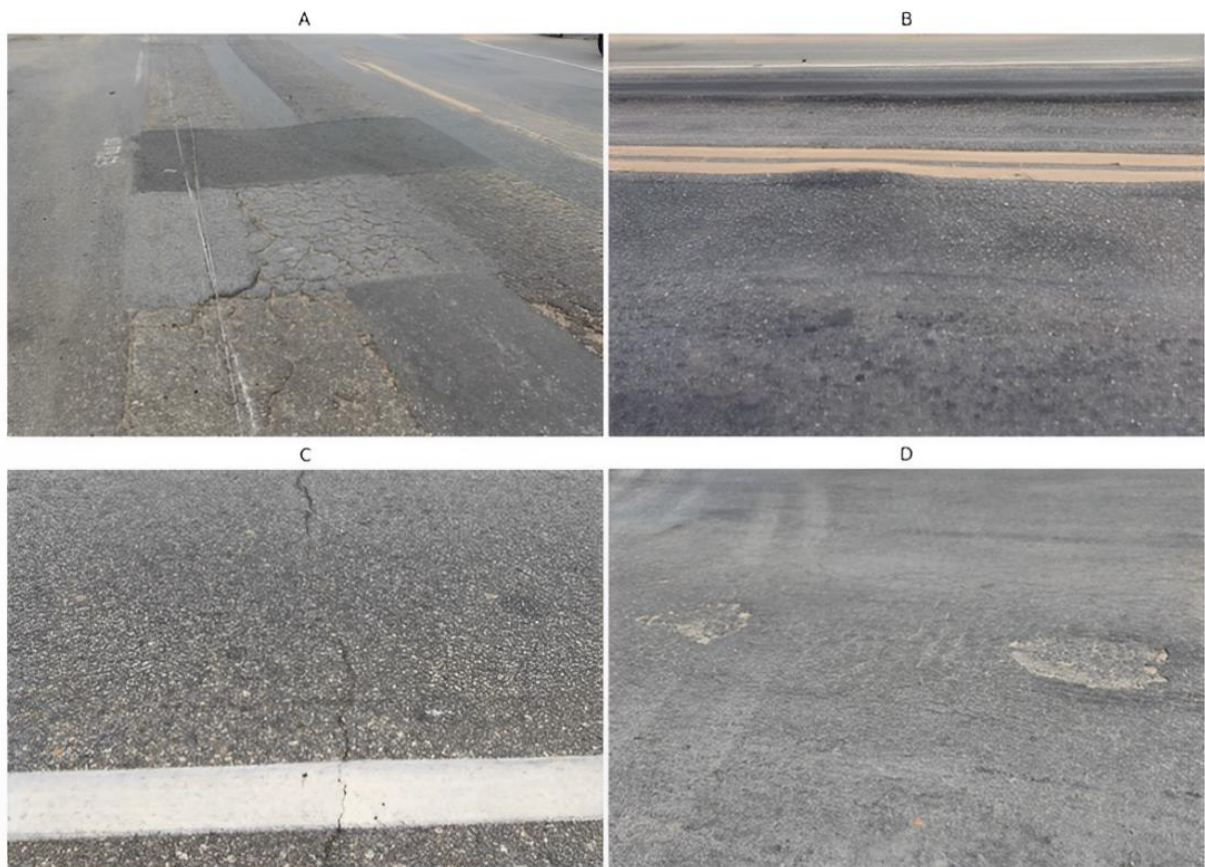
Figura 2. Principais defeitos encontrados na Rodovia BR-222: (a) remendos e trinca couro de jacaré (b) afundamentos (c) trincas transversais (d) painelas e desgaste
