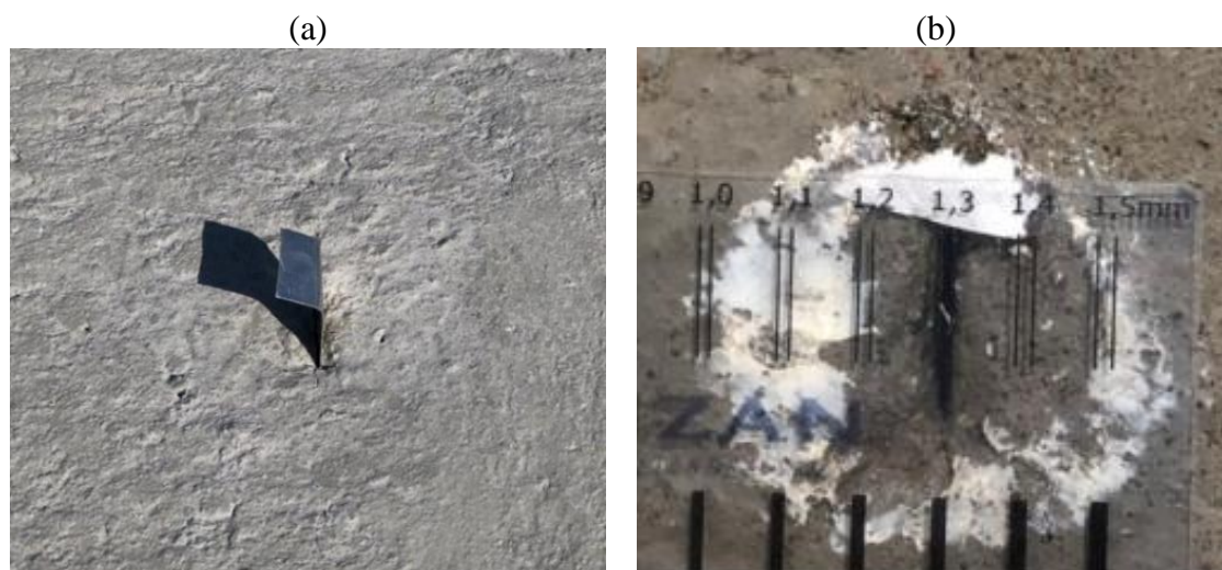
Figura 11. Grietas: (a) Grieta aún con la lámina, (b) Grieta después de quitar la lámina
