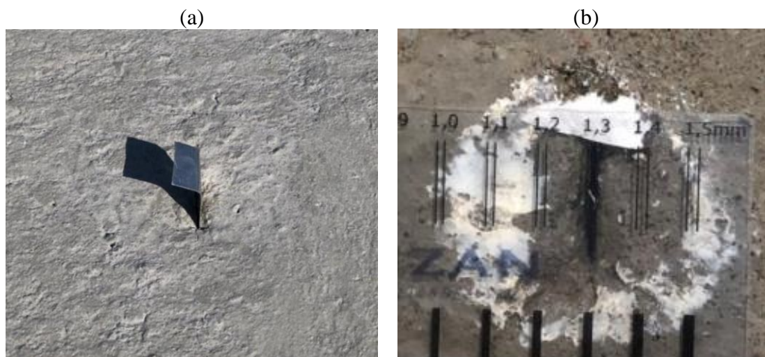
Figura 11. Fissuras: (a) Fissura ainda com a lâmina, (b) Fissura após a retirada da lâmina
