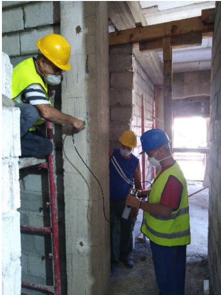
Figura 1. Realización de las mediciones en columnas
