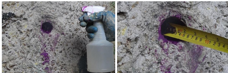
Figura 4: Parede do poço úmido com o concreto alcalino.
