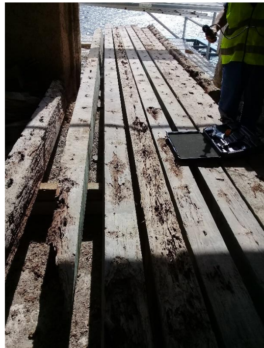
Figura 6. Vigas desmontadas com diferentes manifestações patológicas
