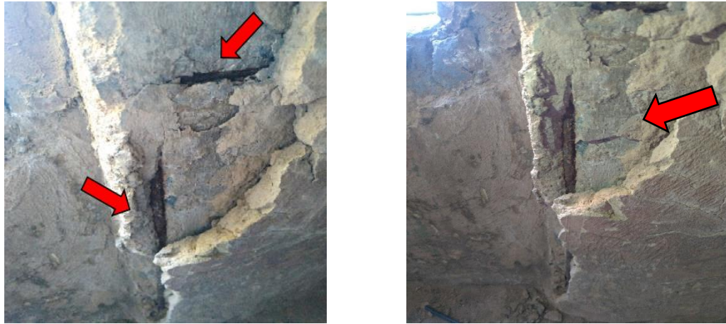
Figura 1. Destacamento do concreto e corrosão das armaduras no elemento P01
