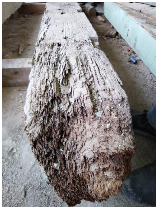
Figura 5. Estado de las cabezas de las vigas
