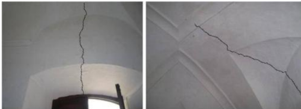
Figura 12. Sector de habitación D9 con fisuras
