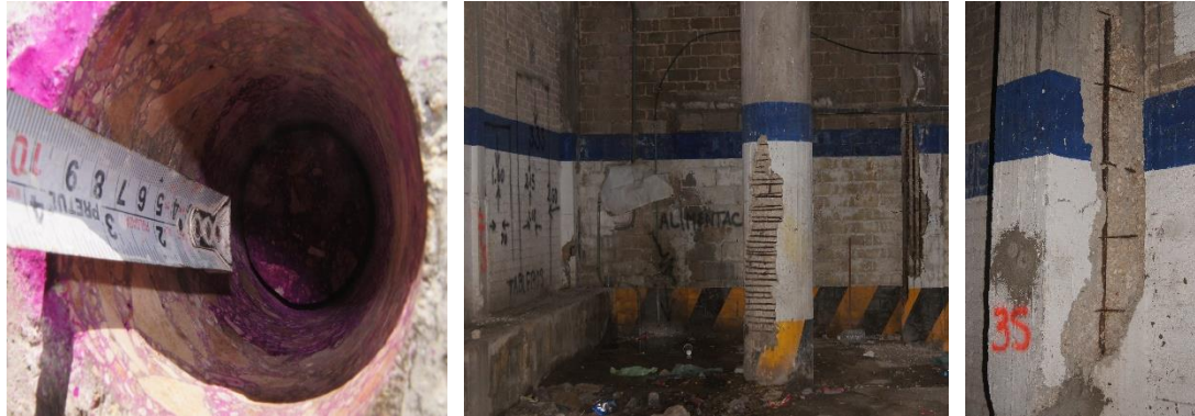
Figura. 3. Carbonatación y desprendimiento del concreto
