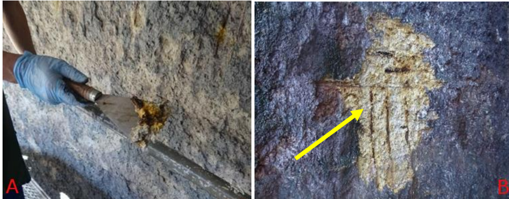
Figura 2. (a) Facilidade de remoção da camada de concreto degradada utilizando uma espátula e (b) trecho de dissolução das armaduras
