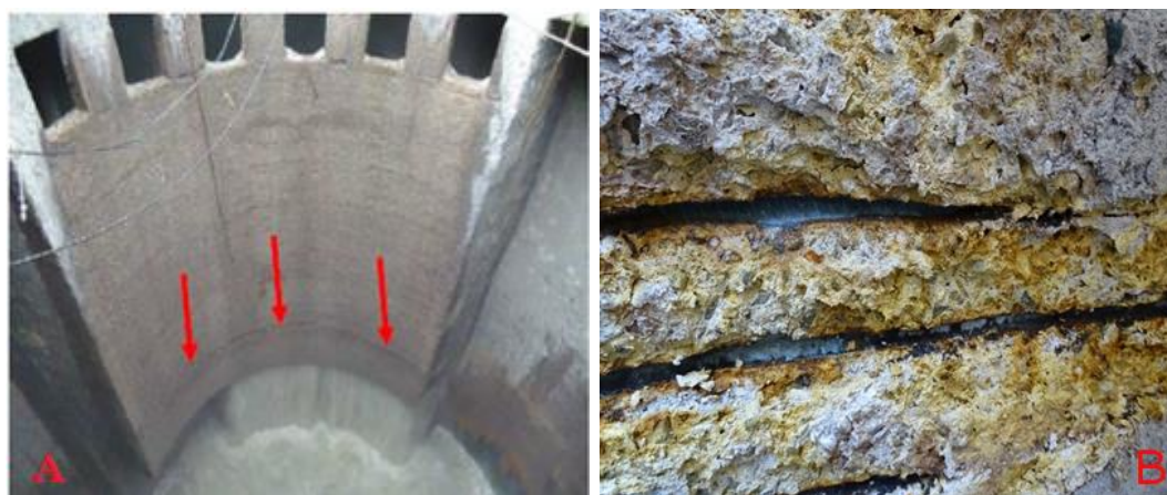
Figura 1. (a) Vista interna do poço úmido (b) Degradação do concreto e do aço
