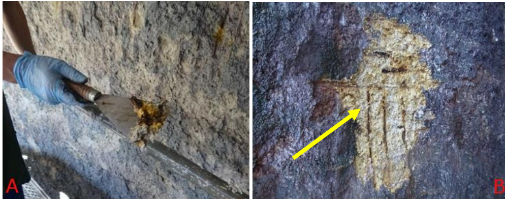
Figura 2. (a) Facilidad de remoción de la capa de hormigón degradado usando una espátula y (b) estiramiento de la disolución del refuerzo.
