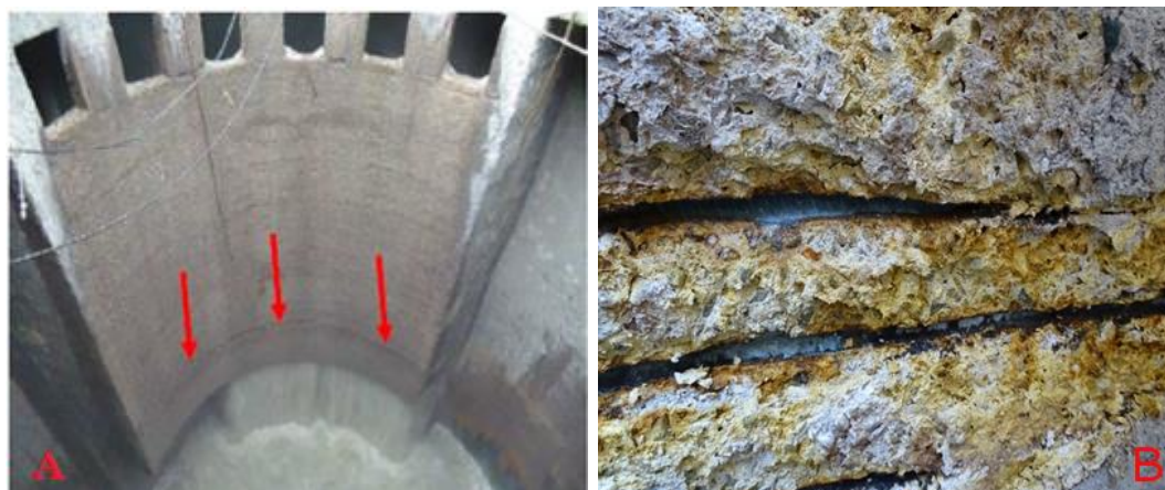
Figura 1. (a) Vista al interior del pozo húmedo (b) Degradación del hormigón y del acero
