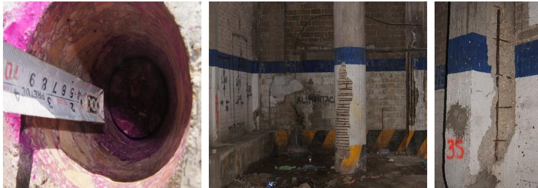
Figura. 3. Carbonatação e desprendimento de concreto
