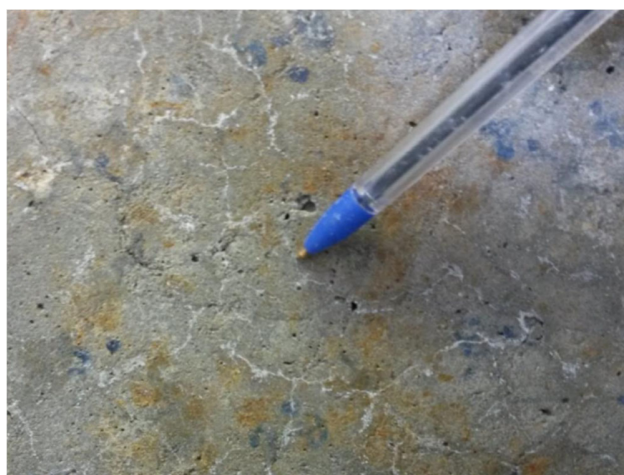
Figura 13. Microfissuras nos corpos de prova.
