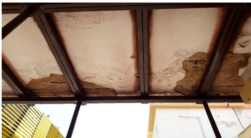
Figura 10. Destacamento do concreto na parte inferior da laje
