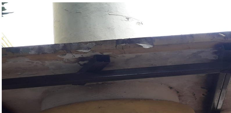
Figura 13. Destacamento da pintura da laje
