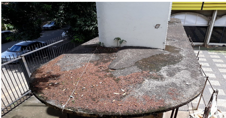
Figura 11. Presença de mofo e sujeira na laje
