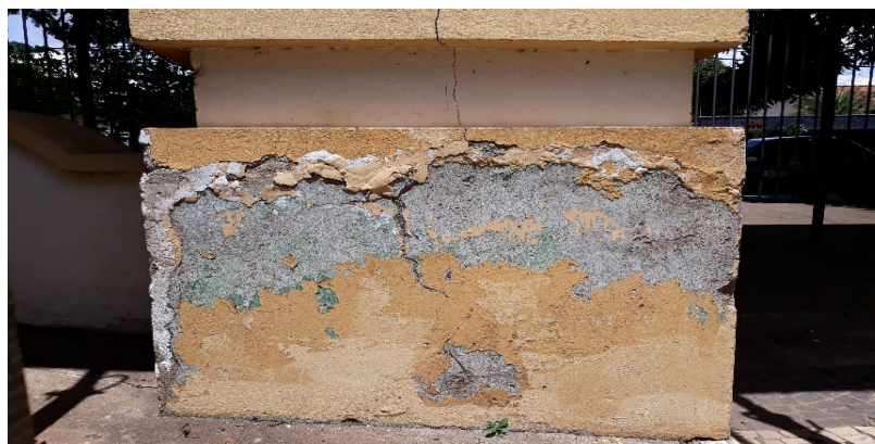
Figura 15. Incidência de fissuras e descoloração da pintura
