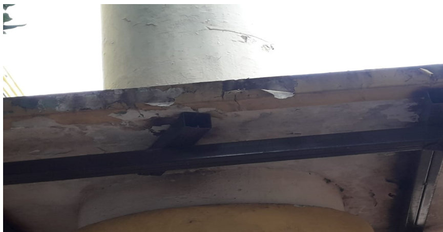
Figura 13. Desprendimiento de pintura de losa
