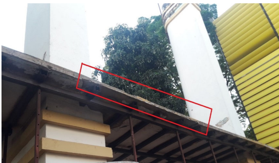
Figura 12. Desprendimiento del borde de la losa
