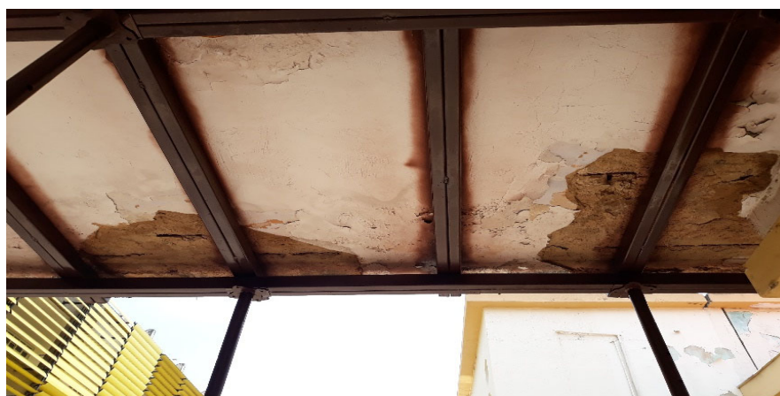
Figura 10. Desprendimiento de hormigón en el fondo de la losa
