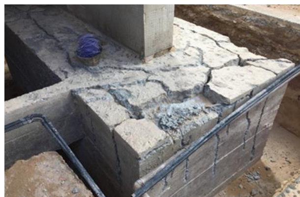
Figura 8. Bloquee el agrietamiento con RAA.
