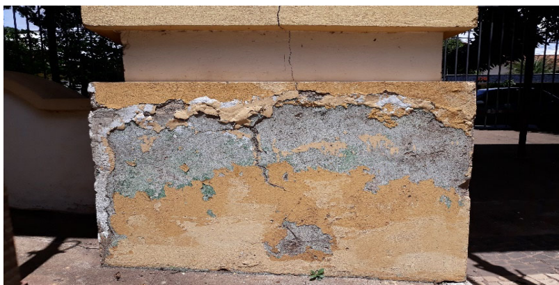
Figura 15. Incidência de fissuras e descoloração da pintura
