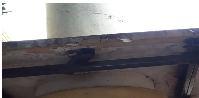
Figura 13. Destacamento da pintura da laje
