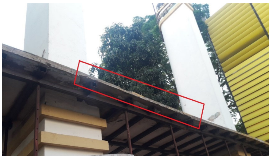
Figura 12. Destacamento da borda da laje
