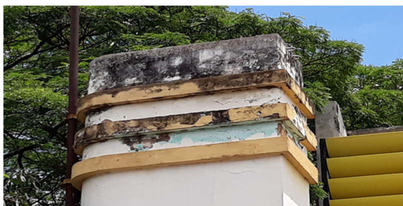
Figura 14. Sujidade e destacamento da pintura no topo do pilar
