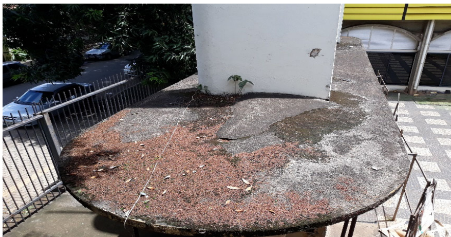
Figura 11. Presença de mofo e sujeira na laje
