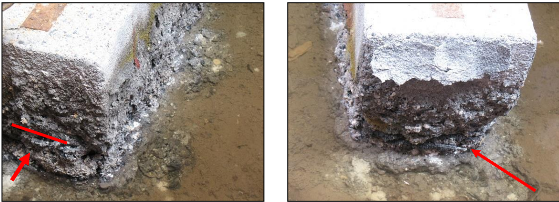
Figura 6. Acero de refuerzo expuesto en bases de tanques de Ácido Sulfúrico
