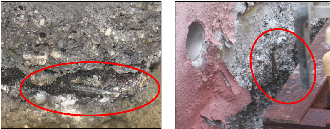
Figura 7. Pérdida de sección y rotura del acero de refuerzo en base de los muros de contención
