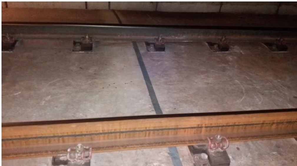
Figura 10. Fibra óptica protegida bajo las vías del tren.
