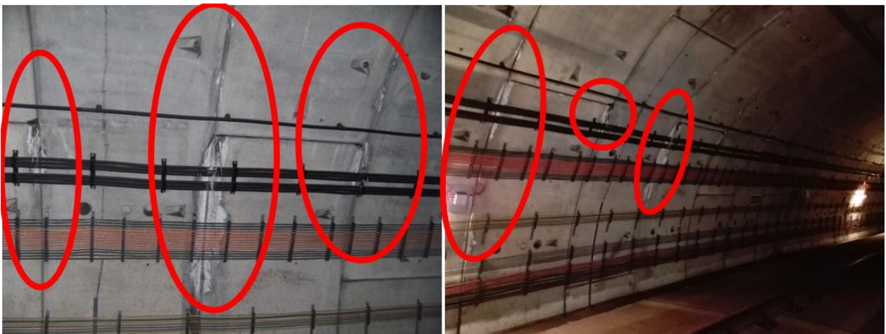
Figura 5. Filtraciones (lixiviaciones de las cales del cemento).
