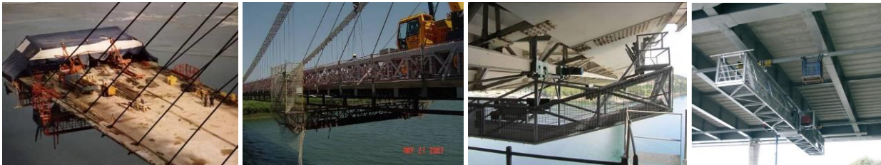
Figura 7. Izquierda: pasarelas provisionales de obra para acceso bajo el tablero del Viaducto C. Fernández Casado (cortesía del Ing. D. Pablo Díaz Simal) y del Puente colgante de Amposta. Derecha: Pasarelas de inspección y mantenimiento de los Puentes de Rande y Waterford.
