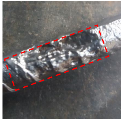
Figura 20. Pérdida de masa de barras de acero (L2).
