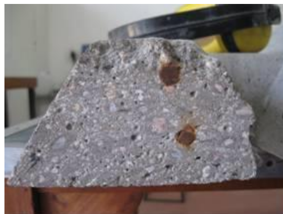
Figura 6: Presencia de armadura en el slat
