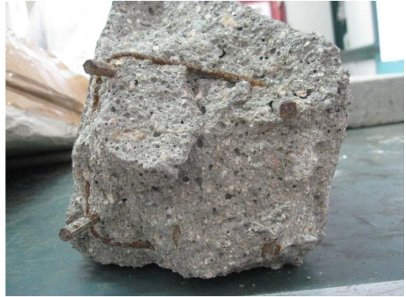
Figura 8: Presencia de armadura en la viga
