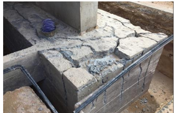
Figura 8. Fissuração do bloco com RAA
