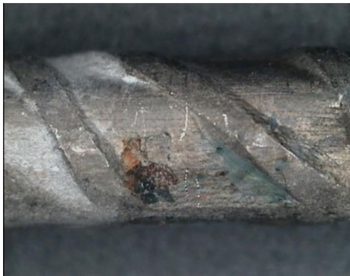
Figura 4. Pequenos pites de corrosão devido ao ataque de cloretos
