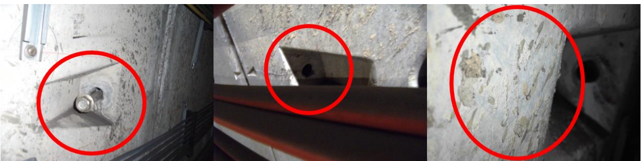
Figura 6. Rugosidade e parafusos de fixação que podem afetar a colocação da fibra.
