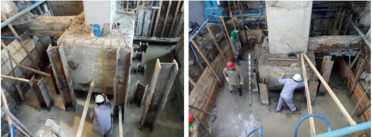
Figura 9. Detalle de la medición de las dimensiones de los encepados existentes y de los pilotes metálicos, después de la excavación y ejecución del concreto.
