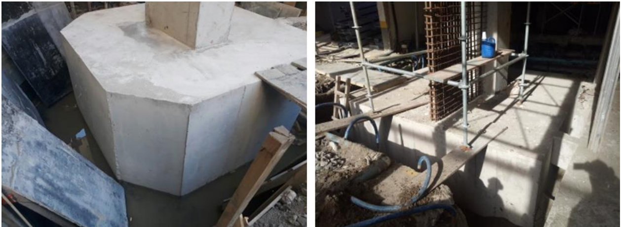
Figura 17. Detalle del aspecto visual y del acabado superficial del concreto de los encepados de cimentación reforzados.
