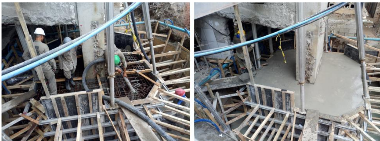
Figura 16. Detalle del vaciado del refuerzo del bloque de fundación, realizado con concreto autocompactante.
