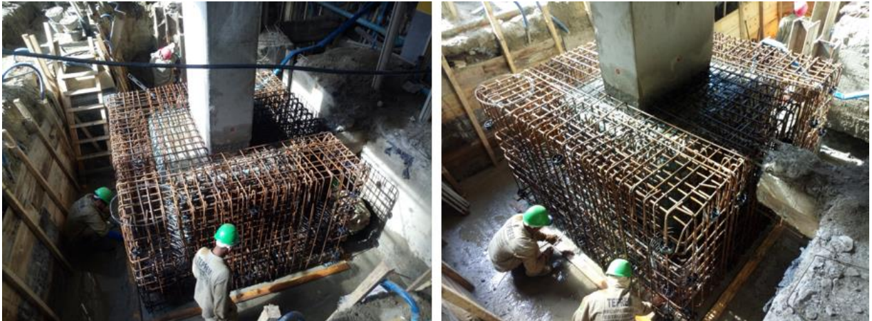
Figura 13. Detalle de la ejecución de los trabajos de armado de refuerzo del bloque de fundación.
