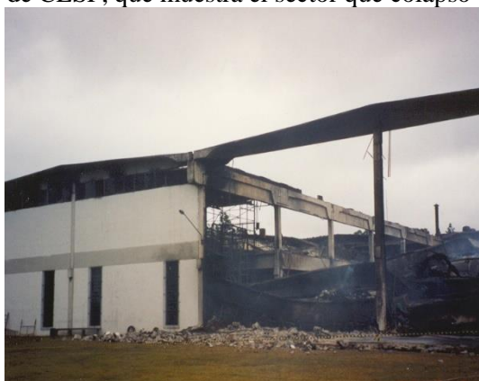
Figura 11 - Ruina del edificio con estructura prefabricada sometido a fuego
