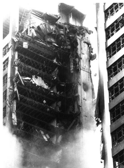
Figura 14 - Detalle de la ruina de la estructura de hormigón del edificio Sede II, que muestra las dos partes restantes de la torre.
