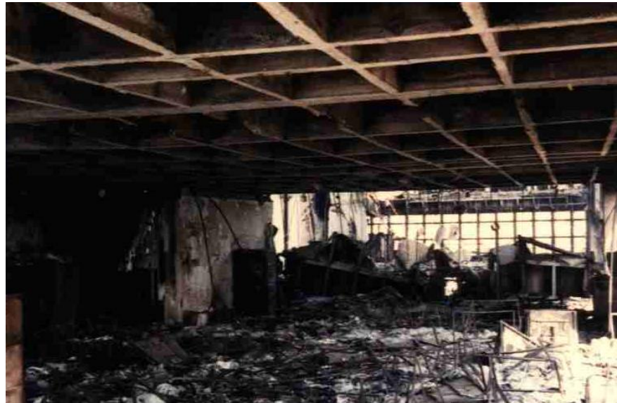
Figura 15 - Vista de la parte frontal de la estructura del edificio Sede II, desde su parte posterior, destacando el vacío dejado por el colapso de la parte central
