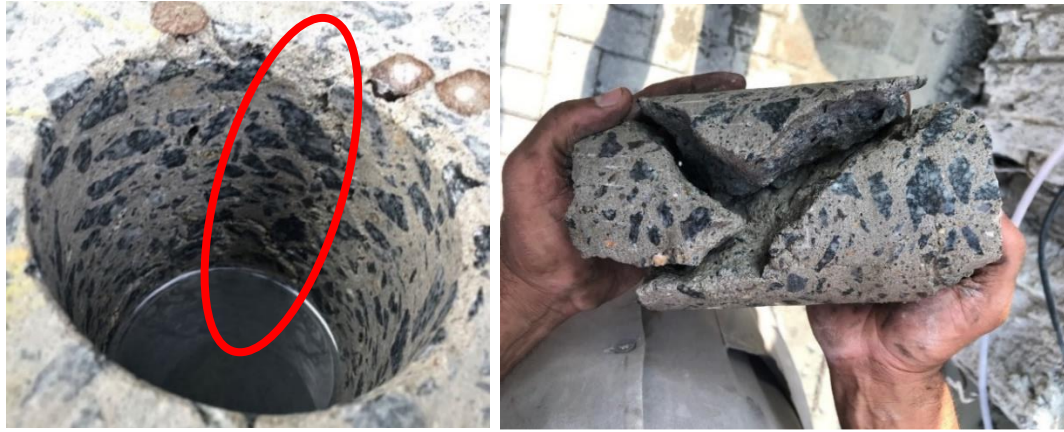
Figura 13. Grietas visibles durante la extracción y testigo descompuesto. (fuente: colección personal de Paulo Helene)
