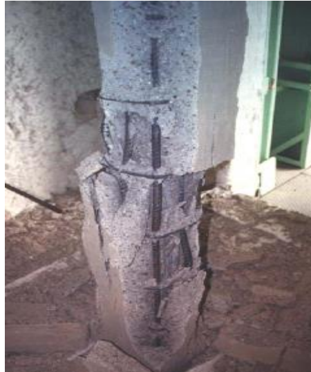
Figura 10. Ejemplo de spalling explosivo en pilares de concreto de alta resistencia. f_{ck} = 83 MPa (Kodur et al., 2005).
