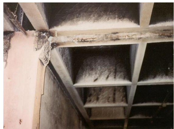
Figura 12 - Desplazamiento de soporte de estructura prefabricada sometido a fuego
