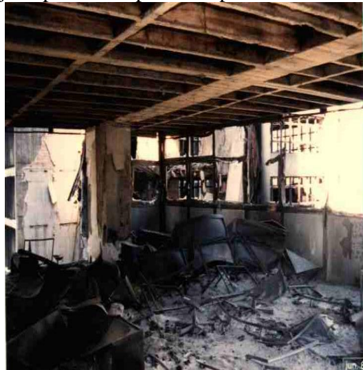
Figura 17 – Estructura del edificio Sede I dañada por el fuego
