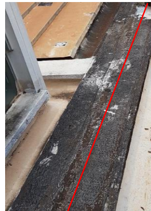
Figura 6. Junta estructural sin sellador
