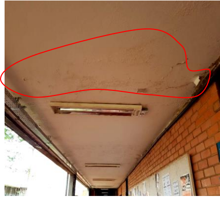
Figura 3. Canales en el revestimiento del techo del pasillo con moho, manchas de humedad y desprendimiento del revestimiento.
