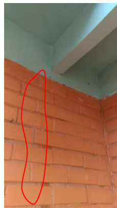
Figura 5. Drenaje de agua en la interfaz viga-mampostería
