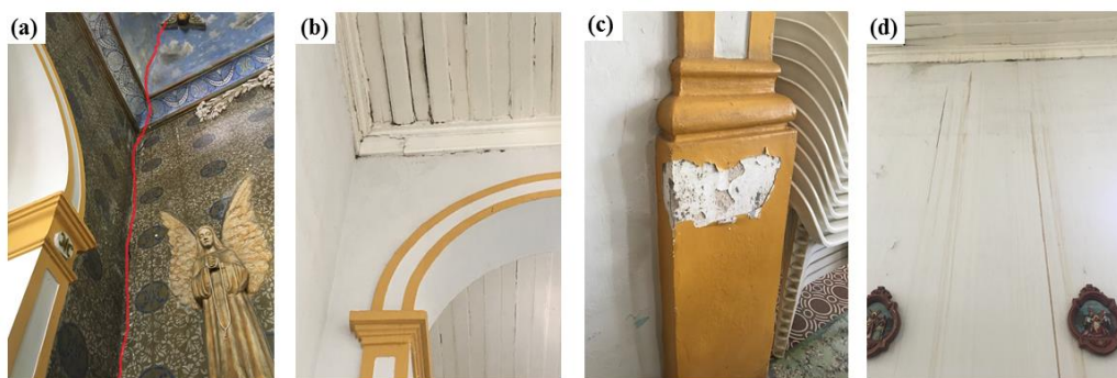
Figura 5. Manifestaciones patológicas internas en la Iglesia de Nuestra Señora del Rosario: (a) grieta, (b) desintegración del revestimiento, (c) desprendimiento y (d) puntos húmedos.
