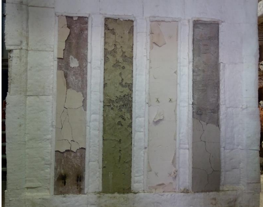
Figura 4. Detalle del estado de los elementos y recubrimientos después de la apertura del horno (evento 1): recubrimientos de yeso formulados, elementos de referencia, recubrimientos de yeso proyectados y recubrimientos de mortero base cemento.
