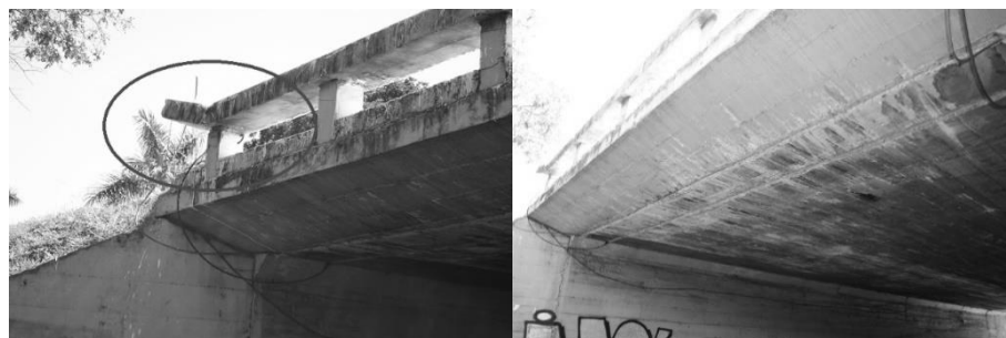
Figura 9. Dano na estrutura do guarda-corpo e vista geral - dano na laje por arrastamento de veículos devido altura.
