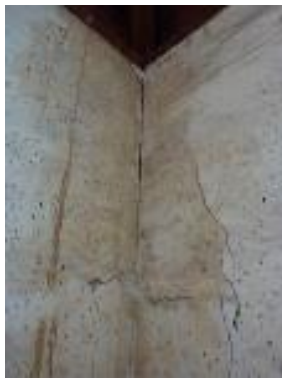
Figura 3. Fissura de 2 cm de abertura na intersecção dos eixos A-1
