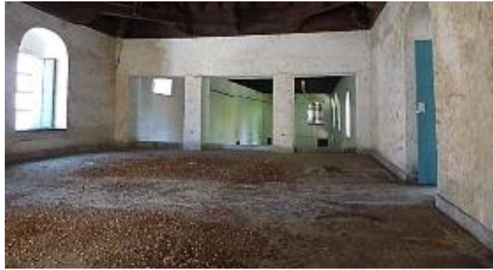
Figura 13. Sujeira nas paredes produto de excrementos de morcego e no local produto dos restos de sua comida.
