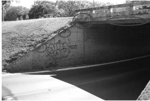
Figura 6. Manchas espalhadas pela estrutura
