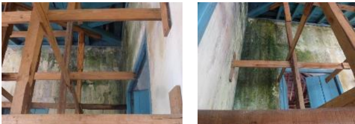
Figura 7 e Figura 8. Fungos na parede da galeria no eixo 2 do Coro.
