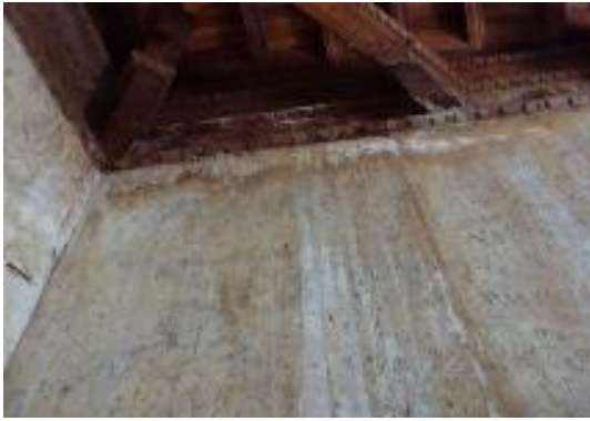
Figura 9. Parede no eixo A com escorrimentos
