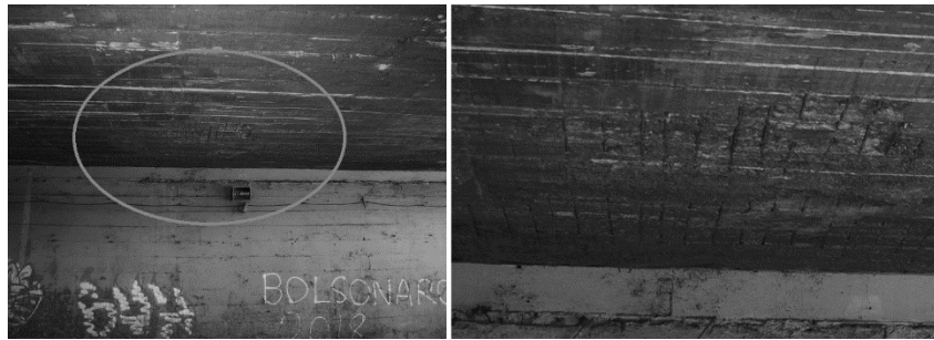
Figura 5. Cobrimento insuficiente e deterioração da Armadura
