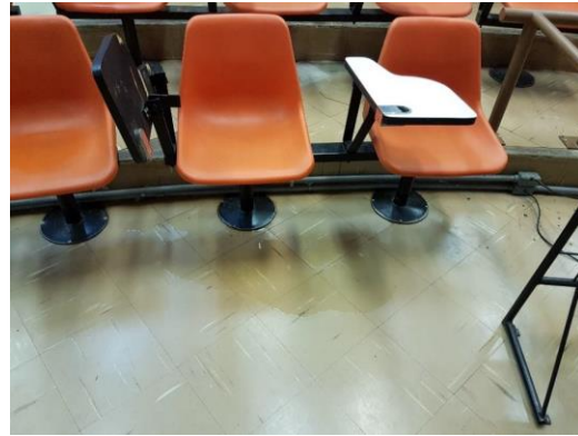
Figura 8. Charcos de agua formados por el goteo.
