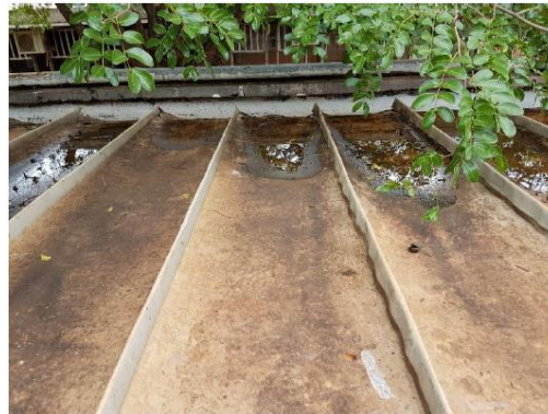
Figura 4. Techo deformado con acumulación de agua y presencia de escombros.
