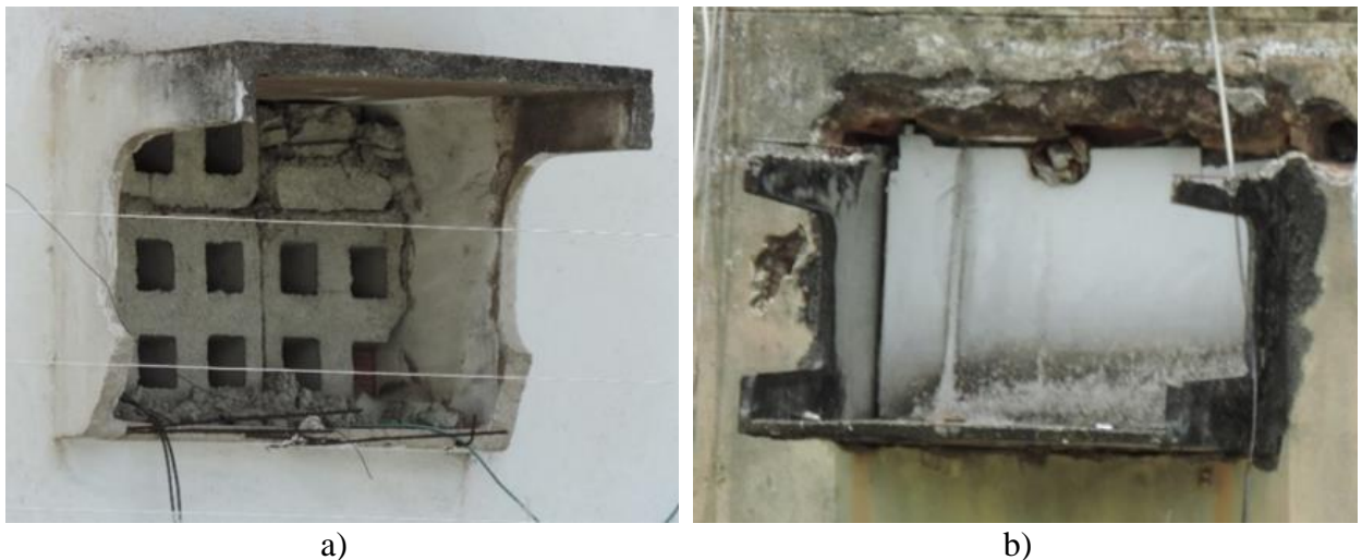
Figura 13. Ruptura parcial en el modelo de tipo de ventana, abierto: a) sin losa de fondo; b) sin losa superior
