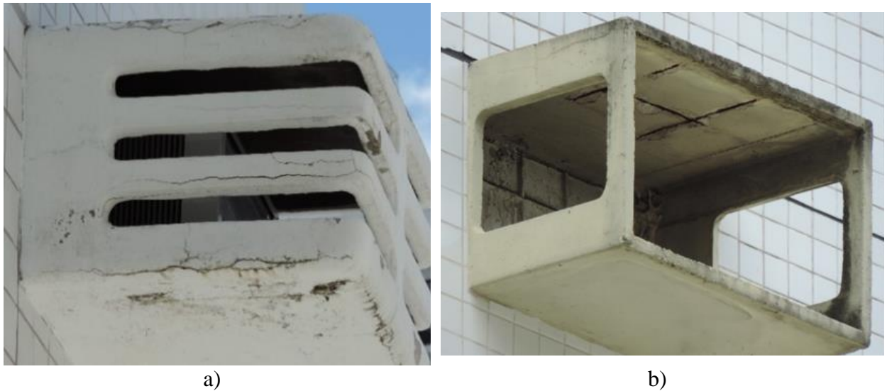
Figura 12. Corrosión de la armadura en el modelo de ventana: a) fisuras; b) desprendimiento de hormigón
