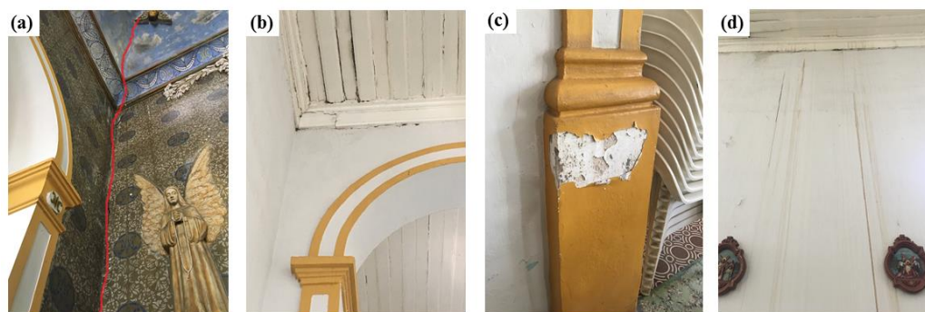
Figura 5. Manifestaciones patológicas internas en la Iglesia de Nuestra Señora del Rosario: (a) grieta, (b) desintegración del revestimiento, (c) desprendimiento y (d) puntos húmedos.
