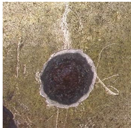
Figura 16. Zona limítrofe da área corroída sem corrosão (Ribeiro Filho, 2018)
